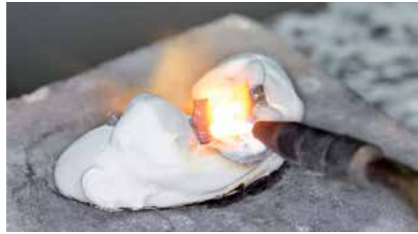
Figura 45 - Aquecimento final do acréscimo da liga em forma de pó na área de união da barra metálica.
